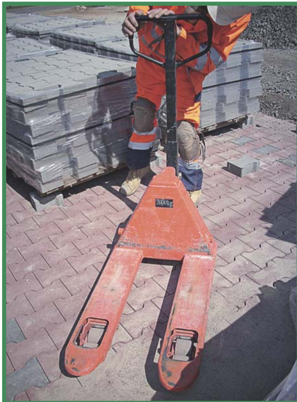
Kontrola stanu wózka przed użyciem.
