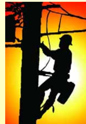
Prace konserwacyjne przy urządzeniach elektroenergetycznych znajdujących się pod napięciem są szczególnie niebezpieczne
