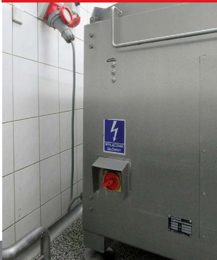
Fot. 5 Prawidłowy sposób podłączenia maszyny do zasilania.
