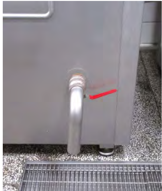
Fot.10. Odprowadzenie mediów z kotła warzelnego zapobiegające wydostaniu się ich na posadzkę.
