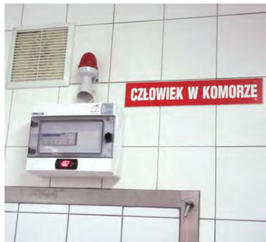
Fot. 11. Przykład oznakowania komory chłodniczej w zakładach przetwórstwa mięsnego.
