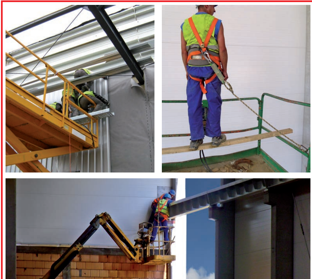
Przykłady takiego braku świadomości nie są na budowach odosobnione. W żadnym razie nie mogą być tolerowane przez osoby z nadzoru.
