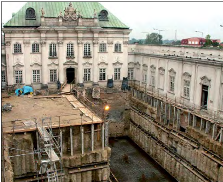
Fot. 23. Zabezpieczenie wykopu palisadą wykonaną w technice jet-grouting z dodatkowym wzmocnieniem w postaci kotew wraz z oczepem. Ten rodzaj zabezpieczenia w przypadku bezpośredniego sąsiedztwa obiektów istniejących, których poziom posadowienia jest powyżej poziomu wykonywanego wykopu spełnia rolę „przedłużenia” istniejących fundamentów.
