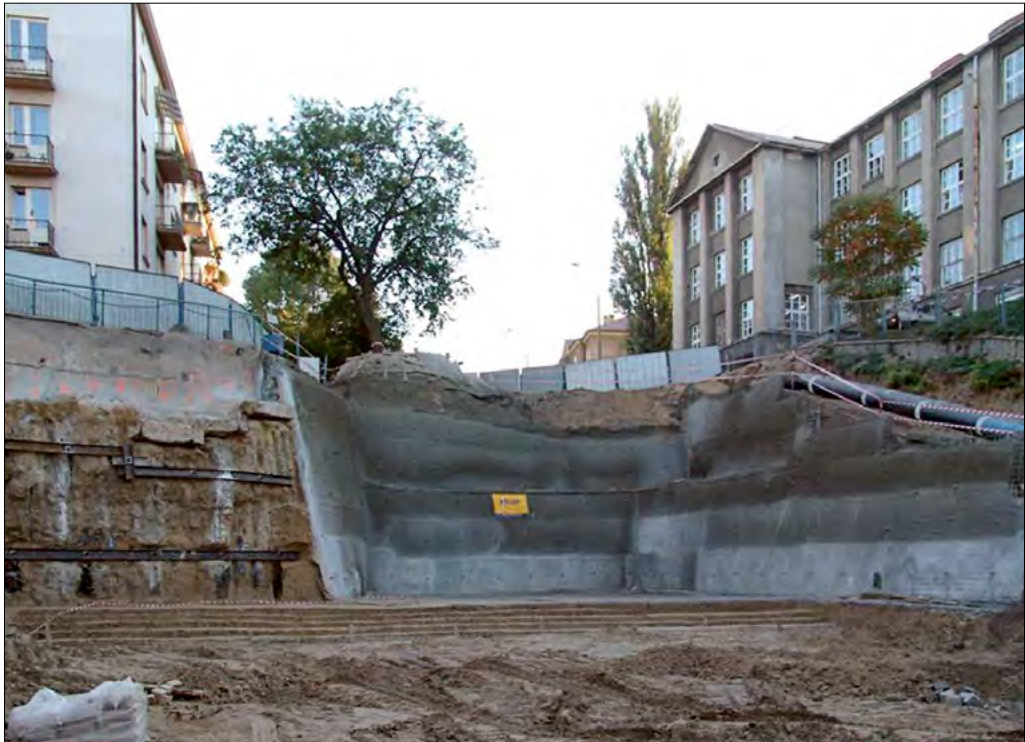
Fot.1. Roboty ziemne prowadzone w ścisłej zabudowie miejskiej. Przygotowanie robót w takim terenie wymaga szczegółowej analizy dokumentacji archiwalnej oraz monitoringu oddziaływania robót na stan przyległych do placu budowy obiektów.
