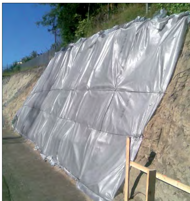
Fot. 12. Powierzchniowe zabezpieczenie skarpy geowłókniną z systemem pionowych/poziomych prętów zbrojeniowych przymocowanych do skarpy za pomocą szpilek.
