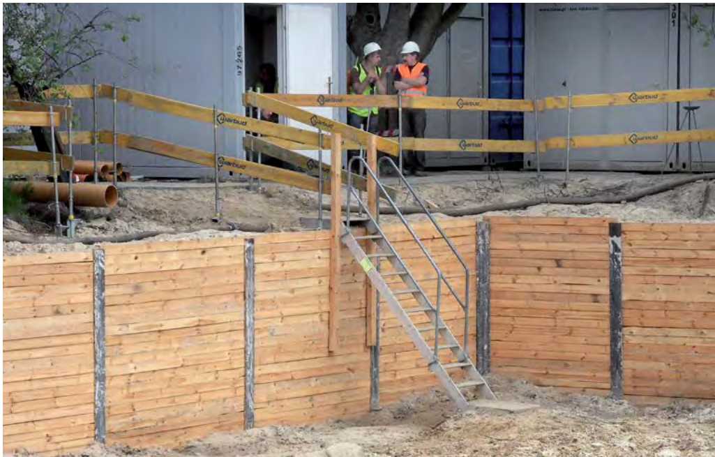
Fot. 5. Balustrady zabezpieczające przed upadkiem z wysokości.
