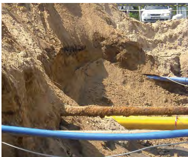
Fot. 9. Nieprawidłowe uformowanie skarpy oraz składowanie urobku bezpośrednio nad krawędzią wykopu jest zagrożeniem dla osób wykonujących pracę w wykopie. Odkryte instalacje podziemne świadczą, że znaczna część prac wykonywana była ręcznie. Pracownicy znajdowali się bezpośrednio w strefie zagrożonej obsunięciem się ściany wykopu i urobku.
