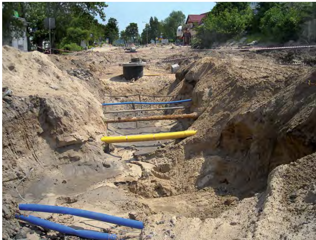
Fot. 3. Instalacje podziemne odkryte podczas prowadzenia robót ziemnych.
