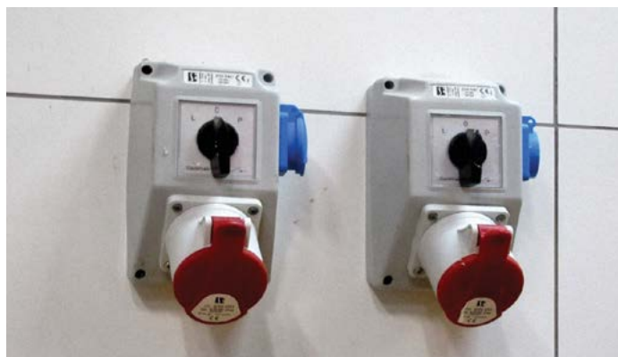
Fot. 5 Prawidłowe gniazda prądu zamontowane na ścianie pomieszczenia produkcyjnego. Możliwość dodatkowego wyłączenia dopływu energii elektrycznej do urządzenia.
