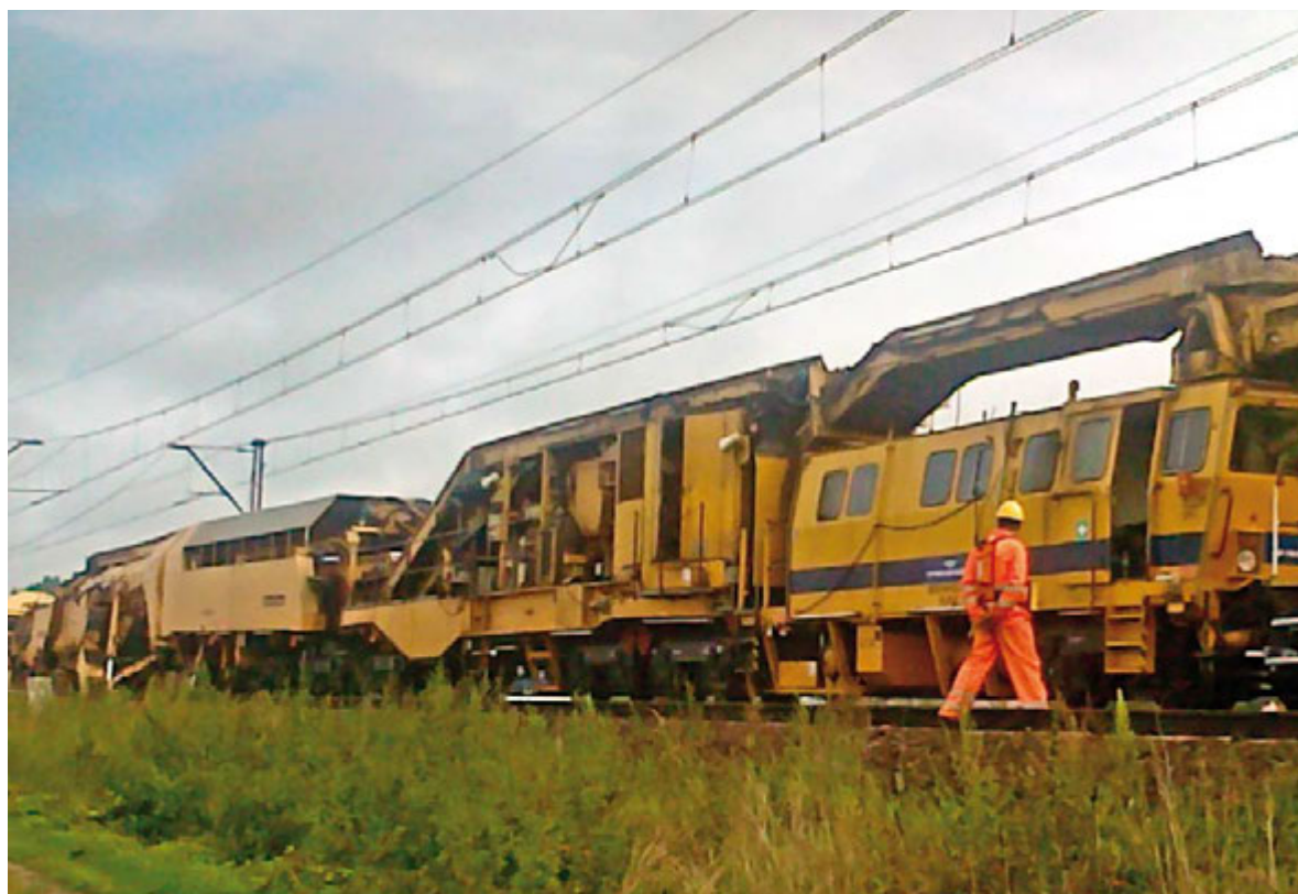
Fot. 20. System ostrzegania zainstalowany na maszynie roboczej, uruchamiany przez pracownika
