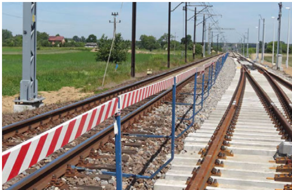
Fot. 16. Wygrodenie międzytorza na stacji Strzałki, podczas przebudowy, w ramach zadania „Modernizacja linii kolejowej nr 4” (Centralna Magistrala Kolejowa)
