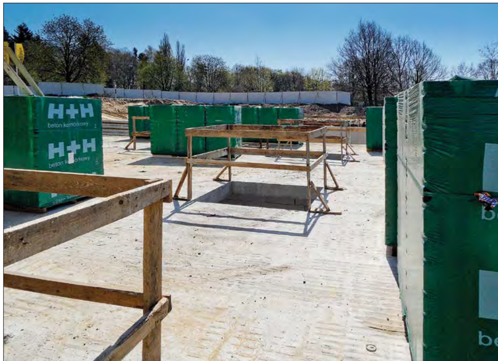
Balustrada bez krawężnika wokół otworu w stropie nie zabezpiecza pracowników pracujących na niższym poziomie przed upadkiem przedmiotów z wysokości.
