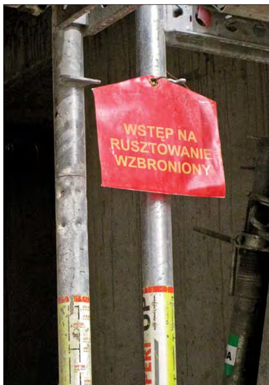
Czytelne oznakowanie wyłączenia z eksploatacji.
