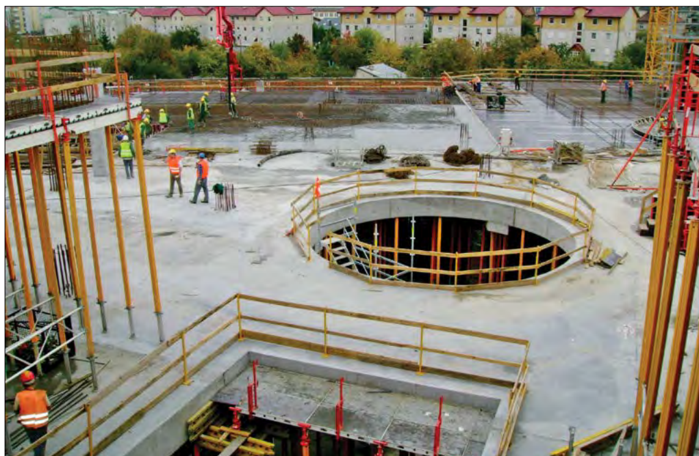
Profesjonalne ogrodzenie otworów stanowi najpewniejsze zabezpieczenie pracowników przed upadkiem z wysokości.
