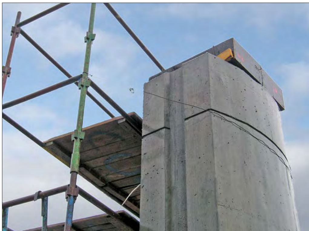
Niebezpieczny sposób mocowania rusztowania.
