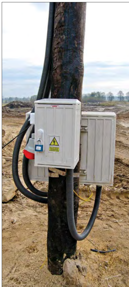
Rozdzielnice elektryczne trzeba zabezpieczyć przed dostępem osób nieupoważnionych.
