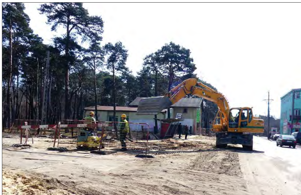
Nie wyznaczono strefy pracy koparki, pomimo że pracuje obok ruchliwej jezdni i czynnego przystanku autobusowego.
