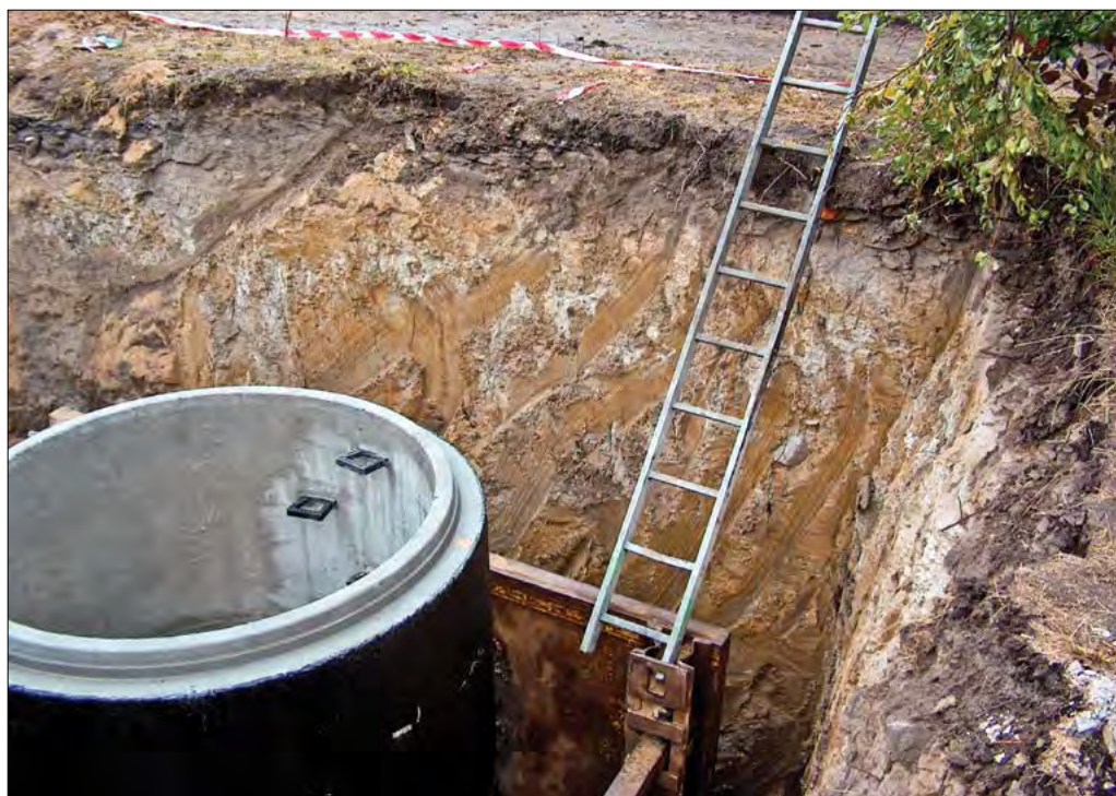
Niestabilne zejście do wykopu, drabina stoi na jednej podłużnicy.
