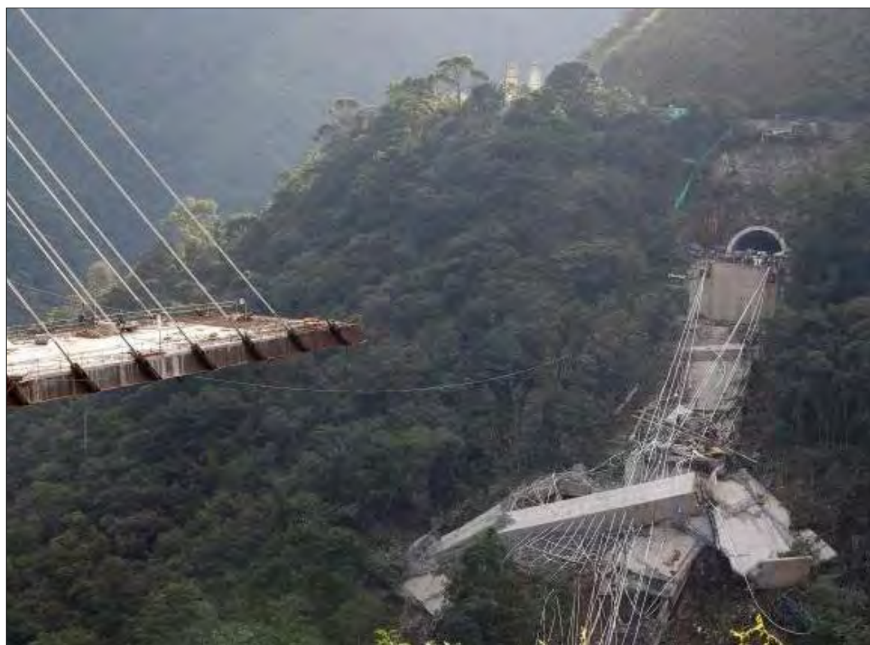
Fot. 2. Katastrofa w trakcie budowy w wyniku bardzo silnego wiatru
