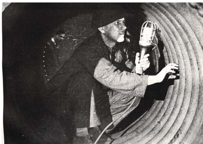
WARSZAWA. Warszawska fabryka budowy parowozów. Bezpieczne czyszczenie kotła parowego przy oświetleniu lampką elektryczną, należycie zabezpieczoną i zasilaną prądem zredukowanym przez transformatory do 24 volt.
