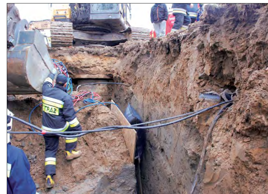
Fotografia z akcji ratunkowej. W głębi wykopu widoczna studnia, do której wykonywany był przekop. Z lewej strony widać fragment gruntu, jaki oderwał się i przygniótł poszkodowanego
