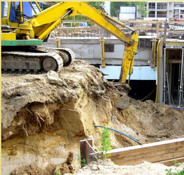
Zabronione jest składowanie urobku w strefie klina naturalnego odłamu gruntu
