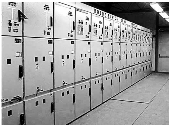
1. Fragment rozdzielni średnich napięć – celki średnich napięć w stacji transformatorowo-rozdzielczej.
