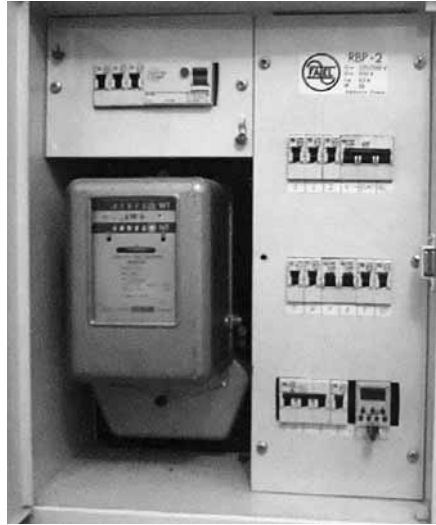
5. Tablica bezpiecznikowa z podstawami nowego typu, w której poszczególne obwo- dy odbiorcze zabezpieczono wyłącznikami instalacyjnymi automatycznymi.
