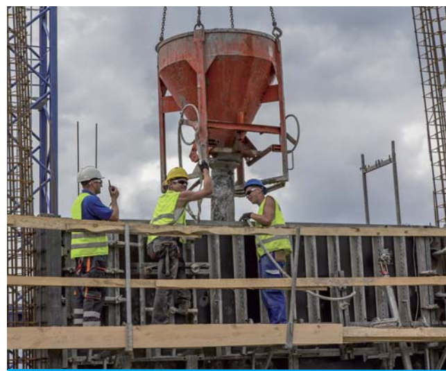
Podesty zabezpieczone balustradą. Pracownik obsługujący urządzenie do zagęszczania betonu powinien pracować w rękawicach antywibracyjnych.
